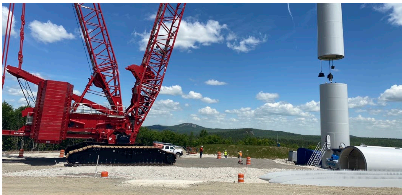
Die Errichtung der Windräder läuft! In Maine soll bis Jahresende der W.E.B-Windpark Silver Maple in Betrieb gehen.
