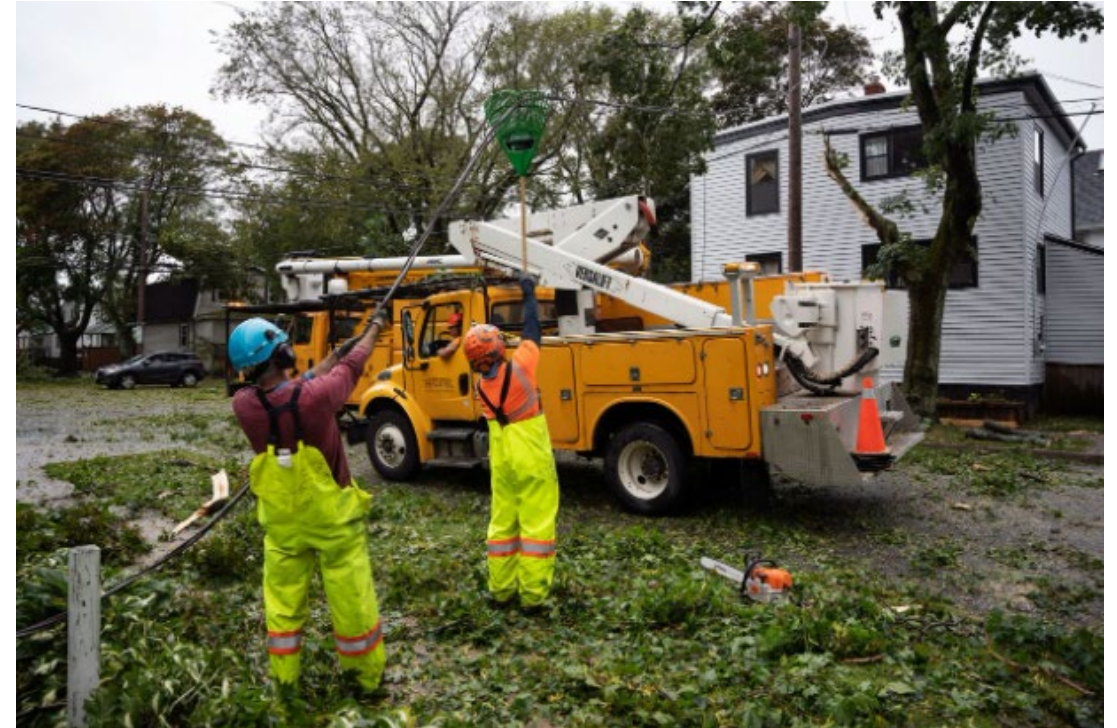
Aufräumarbeiten in Nova Scotia nach Hurricane Fiona, Sep. 2022
