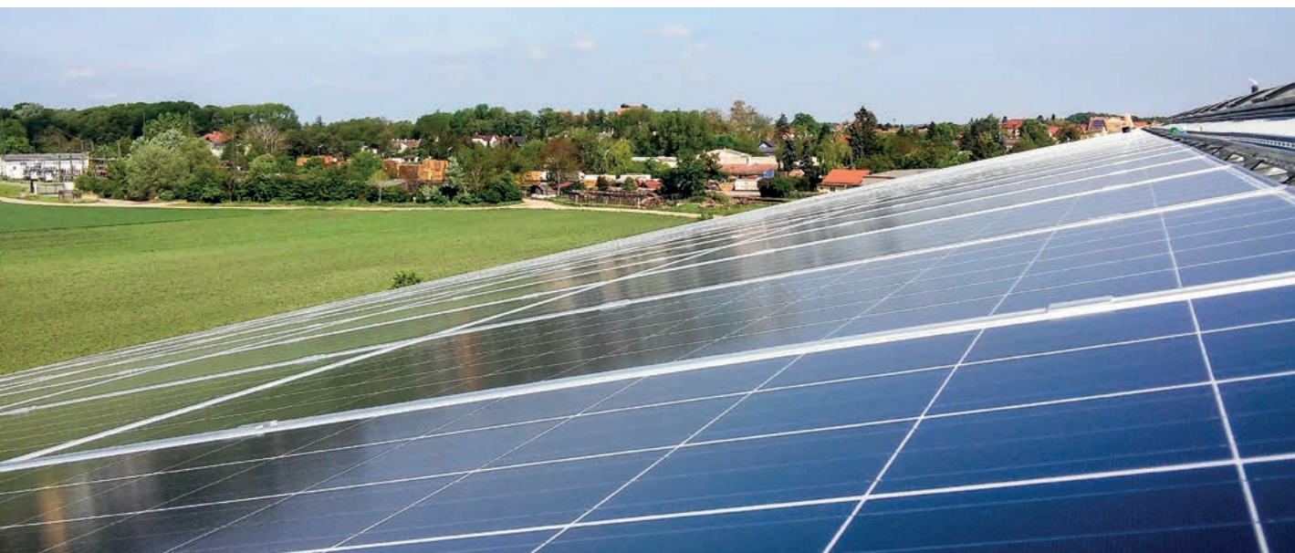
Die W.E.B setzt auch auf die Kraft der Sonne und installierte in Laa an der Thaya drei PV-Anlagen.
