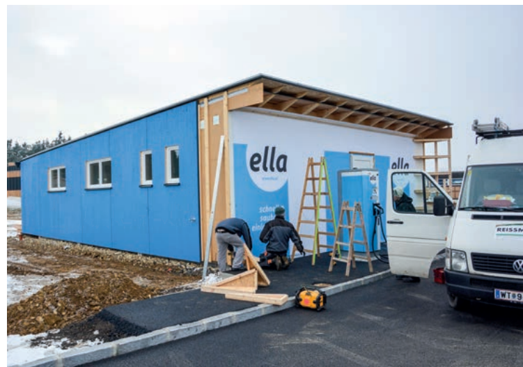
Das neu errichtete ELLA-Gebäude am W.E.B-Firmengelände in Pfaffenschlag wurde Ende November fertiggestellt.
