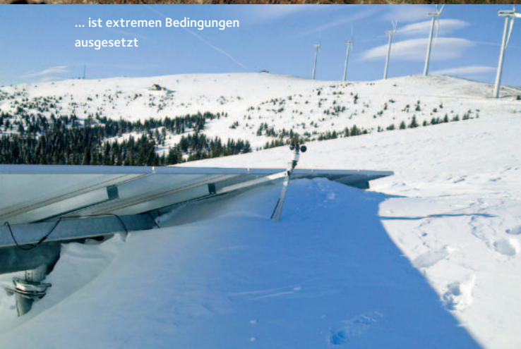
Die Trackeranlage im Tauernwindpark ...
