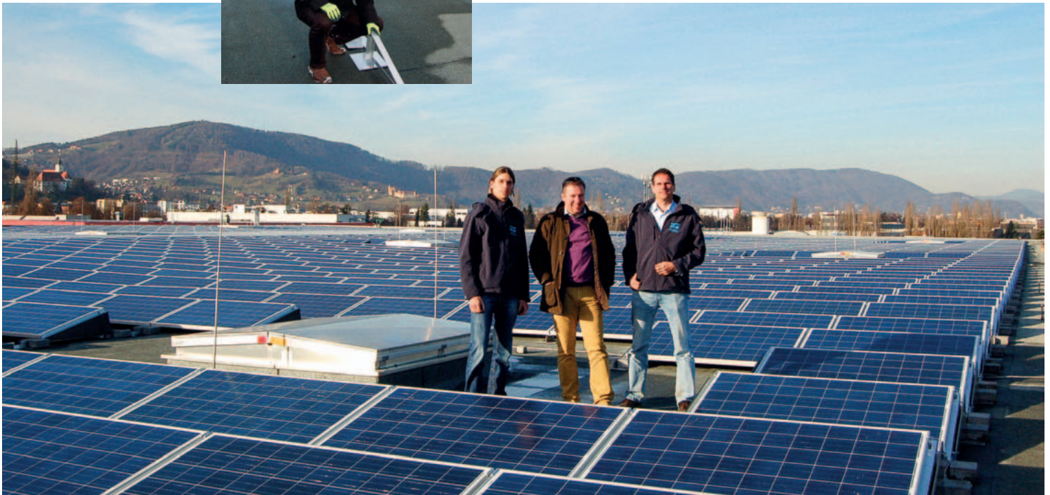
Photovoltaikanlage in Seiersberg auf den Dächern der Pfeiffer Handelsges.m.b.H, Inbetriebnahme: Dezember 2012, Kraftwerksleistung: 928 kW p
