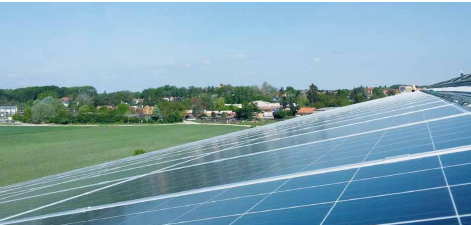
Auf dem Dach der Firma Brantner befinden sich bereits W.E.B-PV-Anlagen. Nun wird die Kapazität ausgebaut.
