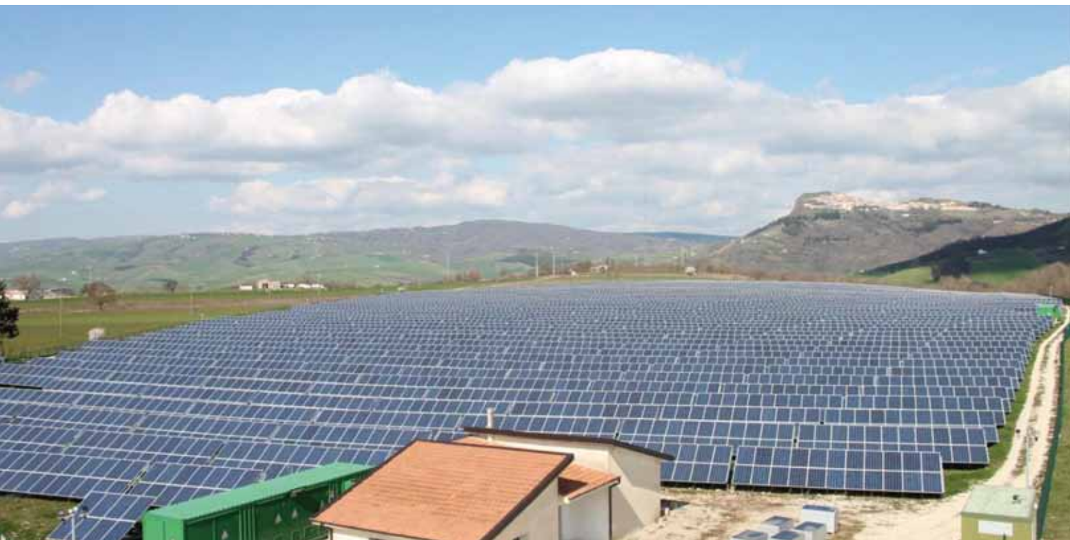
Seit Februar in Besitz der W.E.B: Der PV-Park Conza mit einer Leistung von 3,35 MW p .
