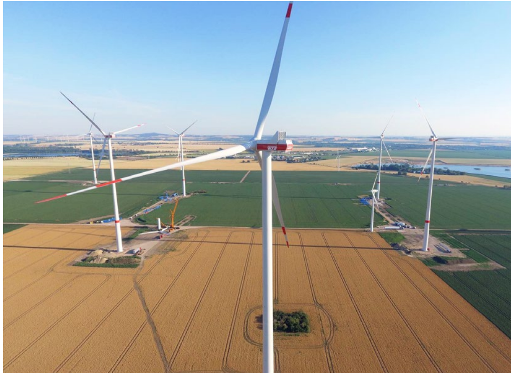
Gemeinsam mit ihren Investoren sorgt die W.E.B für internationales Wachstum! Der Erlös der Green Power Anleihen wurde unter anderem in den Windpark Wörbzig investiert.
