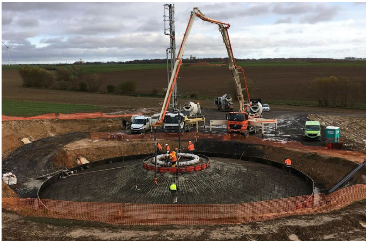
Trotz widriger Wetterverhältnisse liegt der Bau des Windparks Tortefontaine nach wie vor im Zeitplan.
