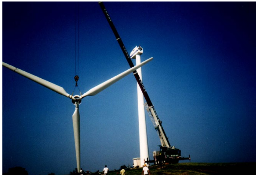
Am 11. Juli 1995 wurde die Anlage in Michelbach montiert; zwei Tage später nahm sie bereits ihren Betrieb auf.
