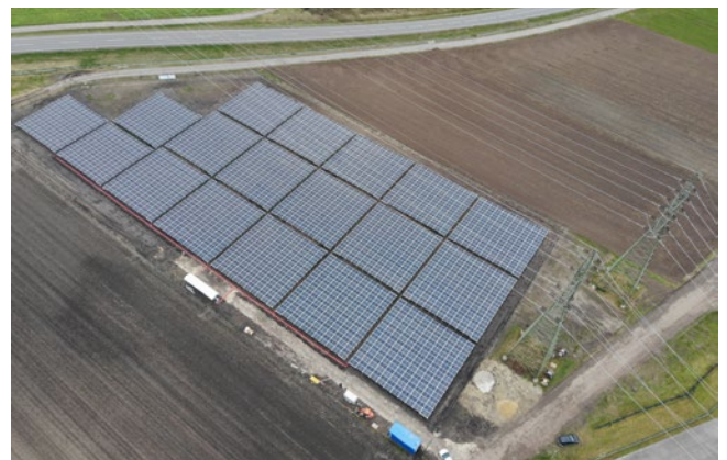
Der Blick von oben! Die neue PV-Anlage der W.E.B am Gelände der Firma Brantner nahm ihren Betrieb auf.
