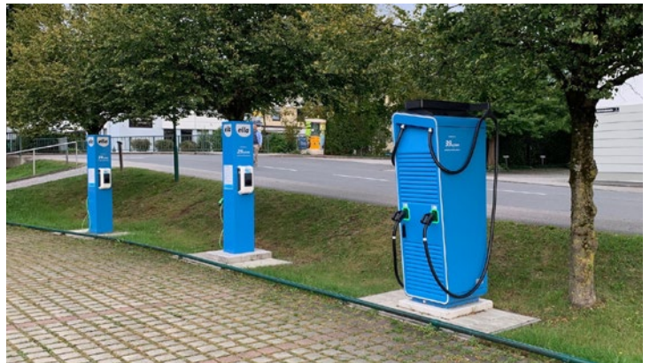
Für jeden Ladebedarf die passende Station wie hier in Vorchdorf
